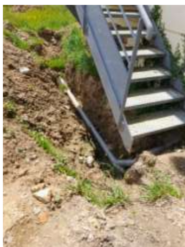
Sortie des eaux usées de l'école
